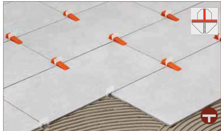
UTILIZZO CON POSA A "T" SULL'INCROCIO PIASTRELLA - USE WITH "T" LAYOUT ON TILE INTERSECTIONS
